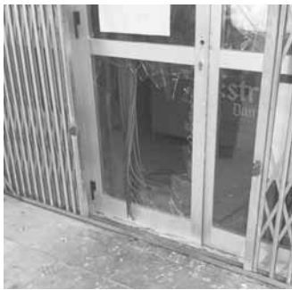
Estat de la porta d'entrada.
