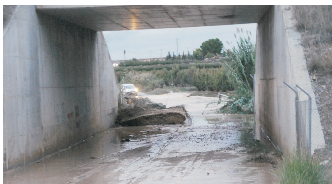
La riuda al pont de les Fonts.
