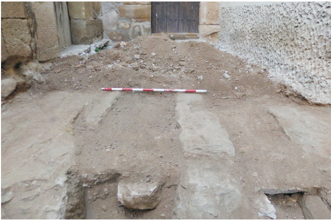
Localització de les dues rases de les antigues clavegueres excavades a la roca.
