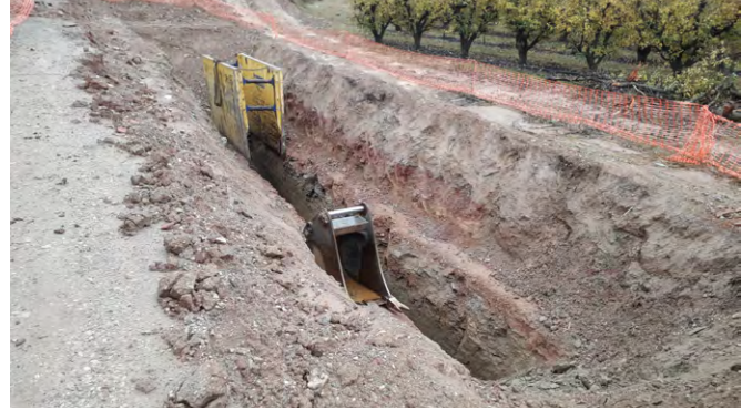
Canonada de la depuradora
